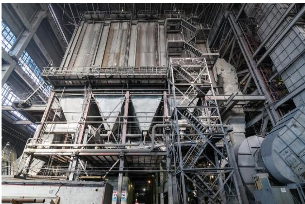
Рисунок 2 - Электрофильтр на Бийской ТЭЦ СГК
